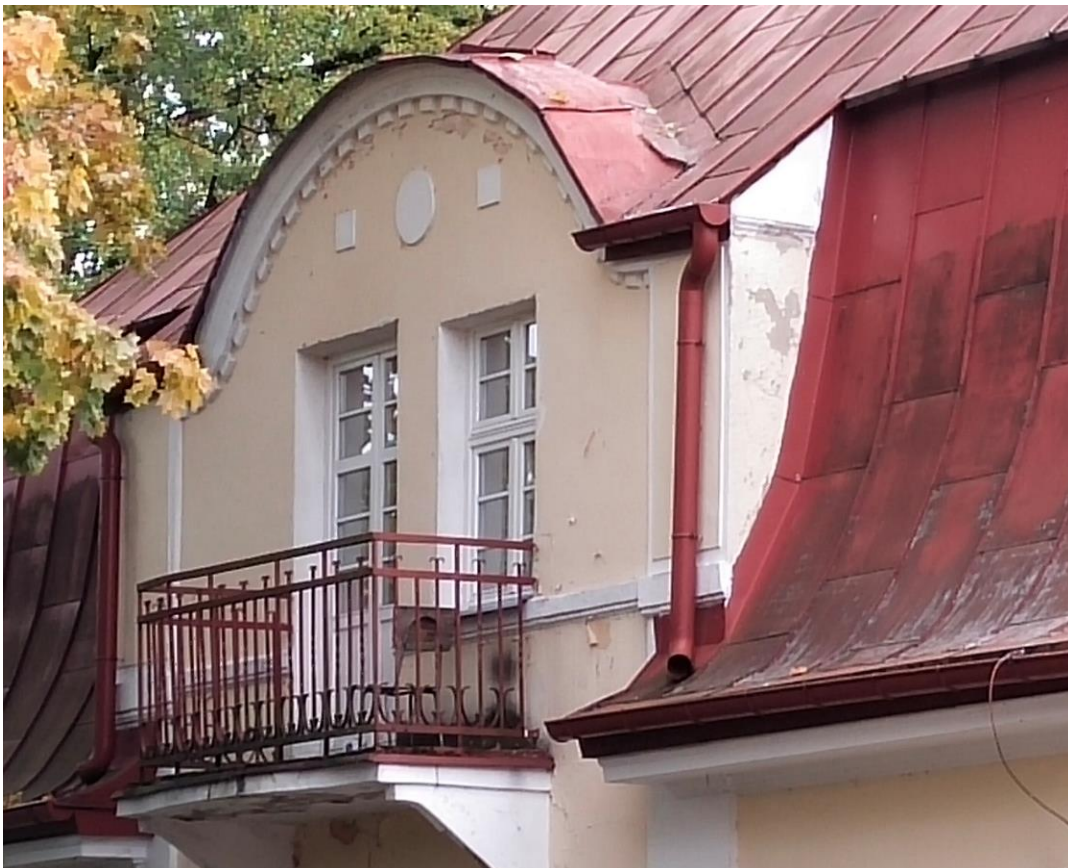
Stan pokrycia dachowego i obróbkę blacharskich lukarny kolistej
